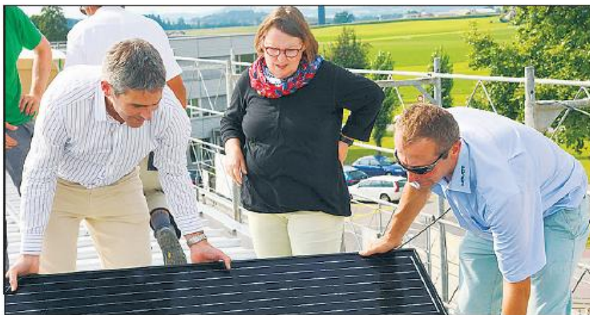
Unter der Anleitung von Lotti Stadelmann (Baukommissionspräsidentin der Sporthalle und Gemeinderätin), montieren die beiden Vorstandsmitglieder André Hegglin (links) und Thomas Weingartner (rechts) eines der 816 Solarmodule. Foto zVg
